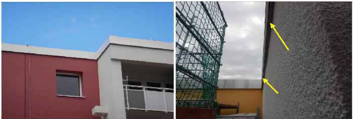
Abbildung: Flachdach. Beispiel einer derartigen Konstruktion bei einem Flachdachgebäude. Die Pfeile zeigen die Öffnungen, abseits von Fenstern.
