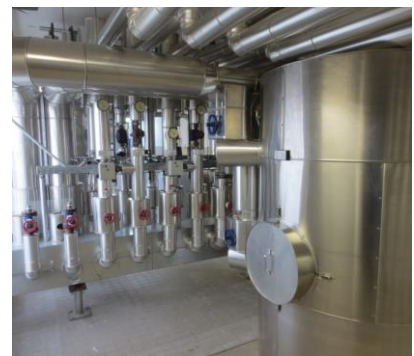
Pufferspeicher zur Wärmeeinbindung
